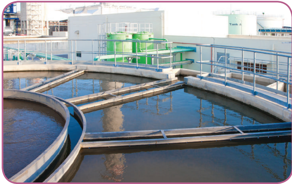
Planta de tratamiento de aguas.
